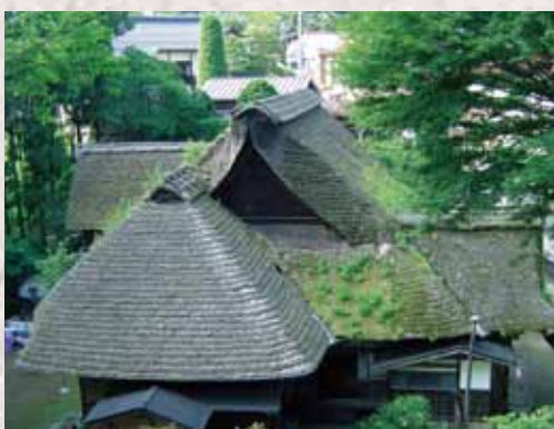
修理前の馬場家
